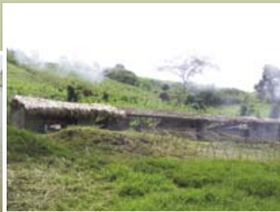
Schulgebäude in Kongo, dessen Dach erneuert werden muss
